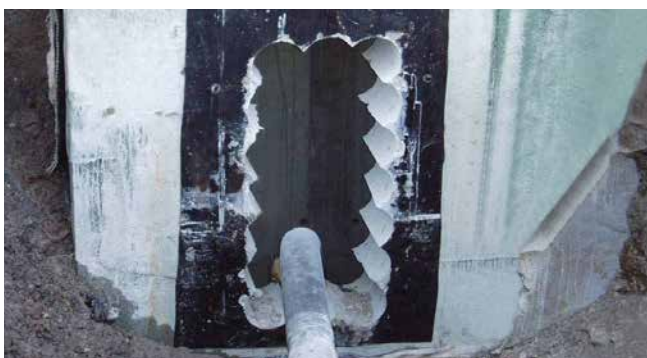
câbles haute tension et les gaines de protection devant être étanchéifiés à posteriori dans la paroi du puits
